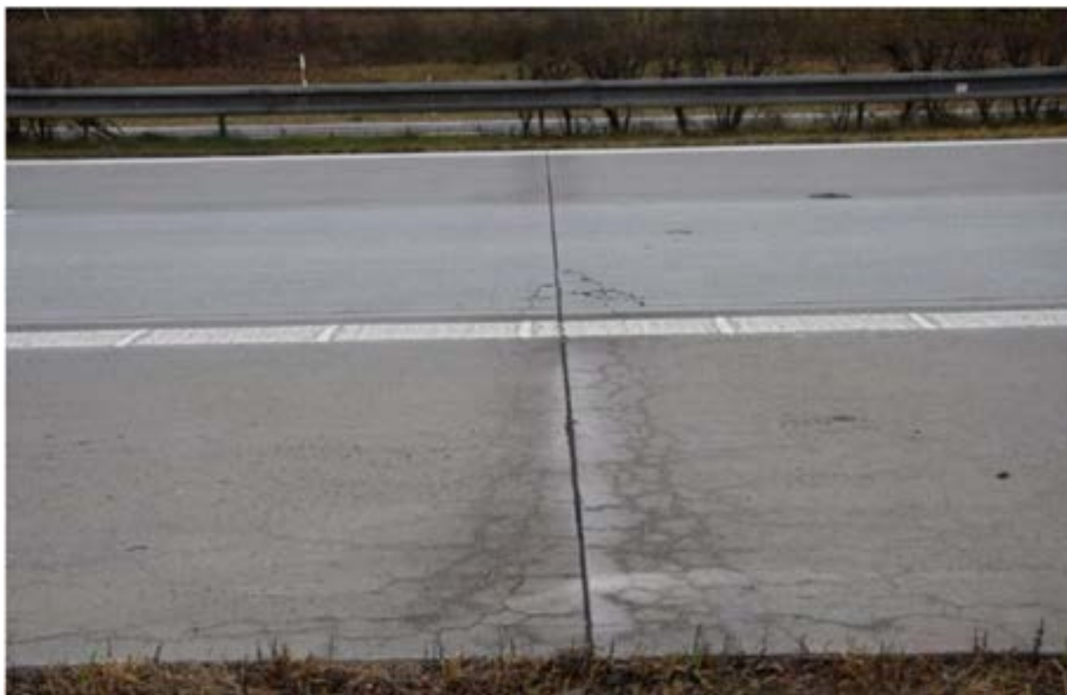
Obrázek 1) Příklad vzniku trhlin na dálnici D1, km 237,4, stáří krytu 17 let.
